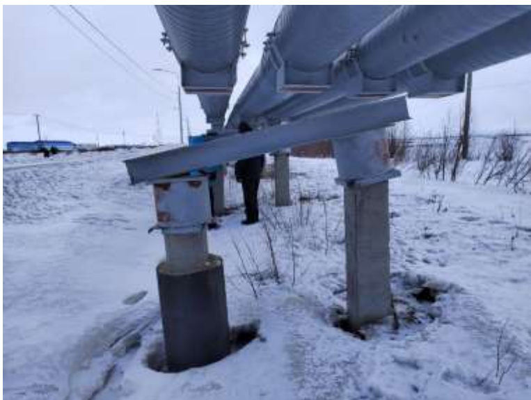
Рисунок 1. Пример отрыва опоры линейного объекта в связи с протаиванием грунтов. Апрель 2025 г., Научно-технологический полигон коллективного пользования «Обдорский», г. Салехард, ЯНАО.
