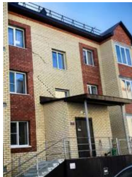
Рисунок 2. Деформации жилого здания в связи с протаиванием и неравномерной осадкой грунтов. Апрель 2025 г., с.Аксарка. Приуральский район, ЯНАО.
