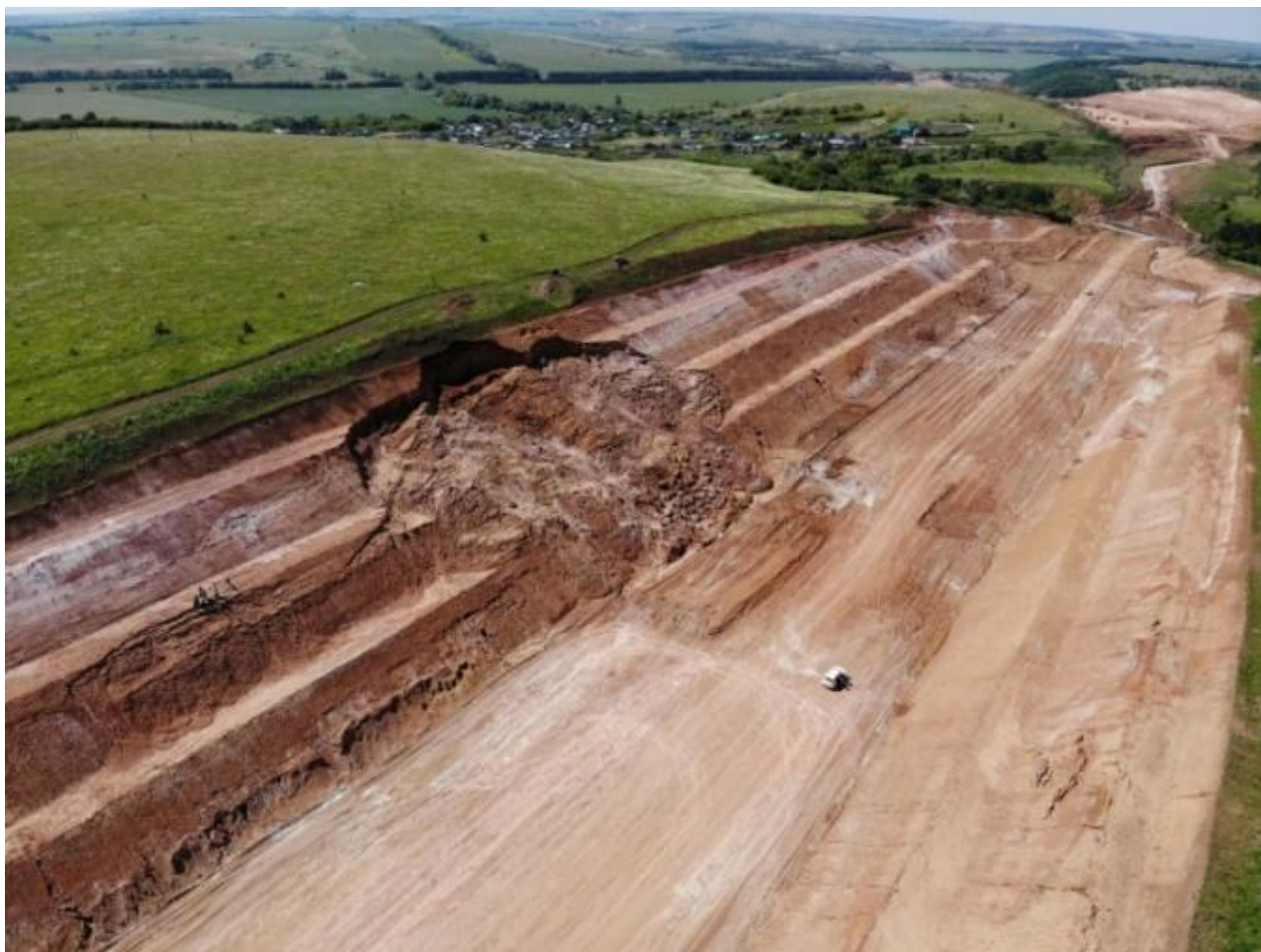
Рисунок 2. Фотография оползневого тела на склоне дорожной выемки у села Гребени
