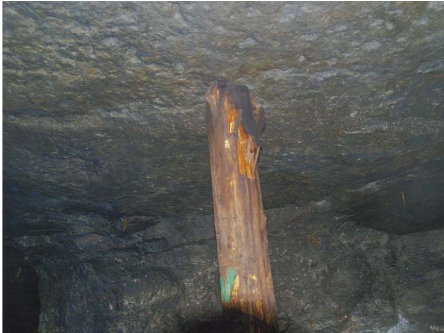
Фото 7. Придавленный крепеж в штольне под районом Зеленая роща
